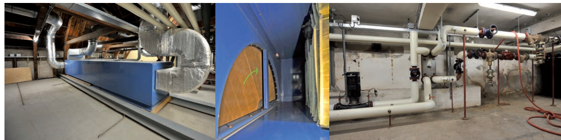
Toepassing van balansventilatie met WTW - in het midden is een warmtewiel in beeld - werkt comfortverhogend en energiebesparend. De aanvoerleidingen naar de luchtbehandelingskasten moeten daarbij steeds optimaal geïsoleerd zijn (rechts).
